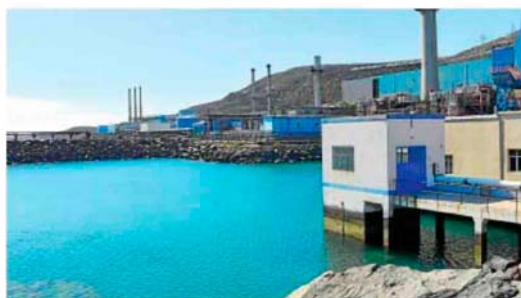
Módulos de desalación en Piedra Santa. c7
